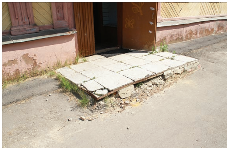
Крыльцо ул. Александровича, 9, было
